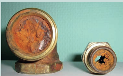
För att återfå systemets effektivitet och för att systemets ska bete sig som kalkylerat kan en rengöring vara nödvändig, för att därefter fylla på med vätskor som motsvarar kalkylerade egenskaper. Foto: Chemiclean
