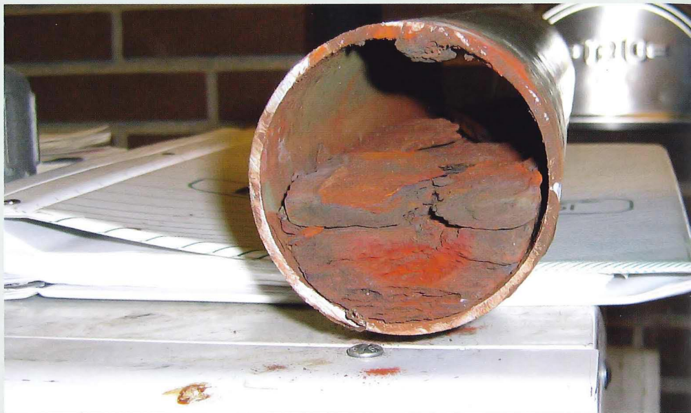
Ilgengrott rör från nybyggt köldbärarsystem. Chemicleans metoder förhindrar bland annat galvanisk korrosion och kalkutfällning. Foto: Chemiclean
